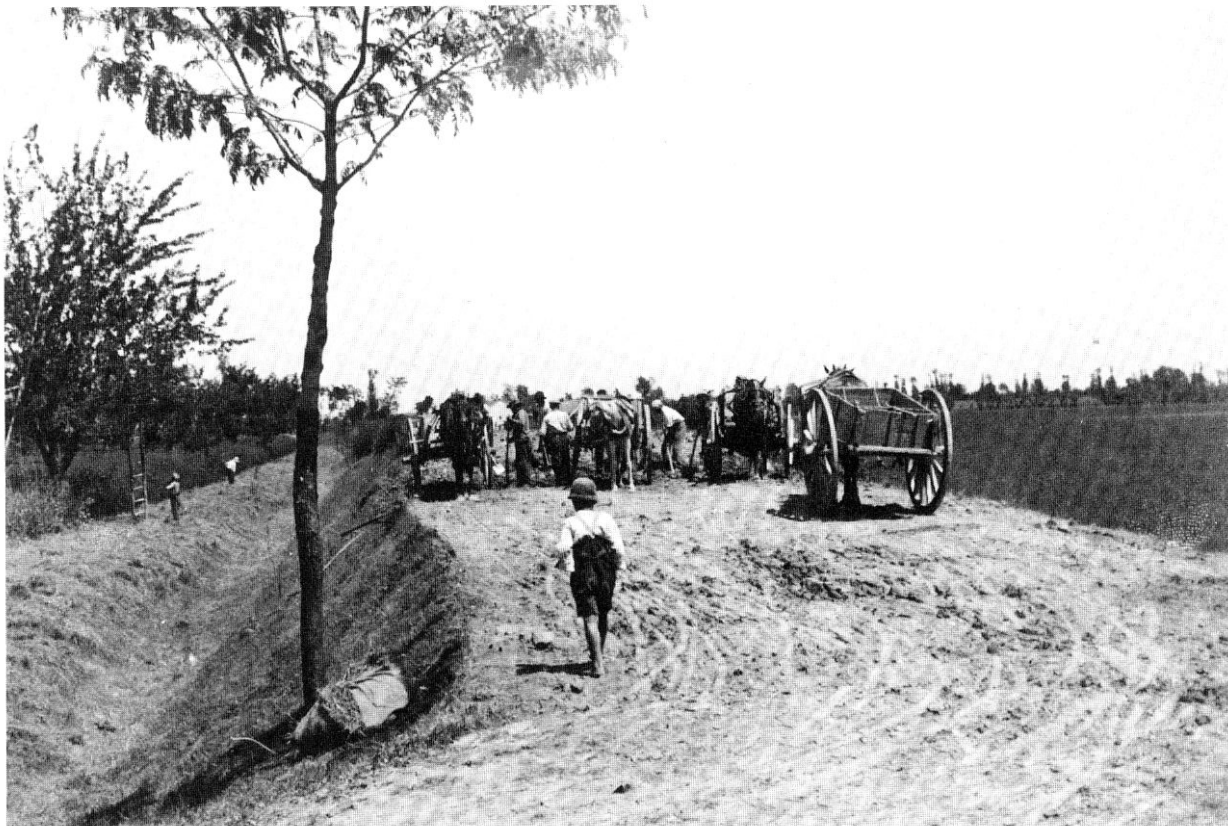
Risvolta di Fossalta, 3 giugno 1931: abbassamento dell'argine destro fra la sezione 4 e la chiavica di Contrapò.
